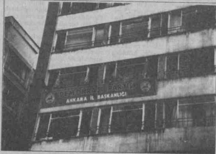
Ankara DEP binası tahrip gücü yüksek bombadan dolayı büyük hasar gördü.
