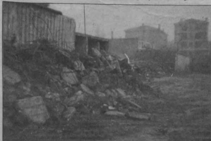
Belediye yöneticilerinin haksız kazanç elde etme hırsı Uğur Duru adlı işçinin yaşamına mal oldu. Eksik malzeme sonucu duvar çöktü. Bina enkaz yığını haline geldi.
